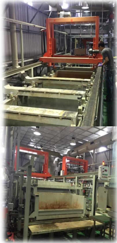
10: 磷酸錳表面處理
